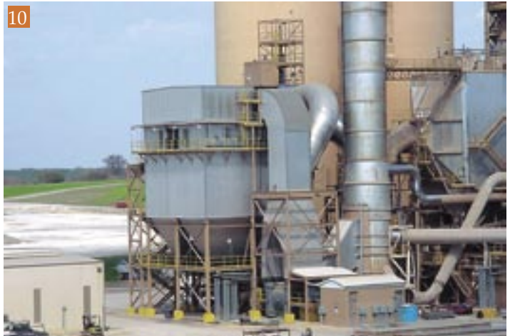
Filtro depolveratore completato.
