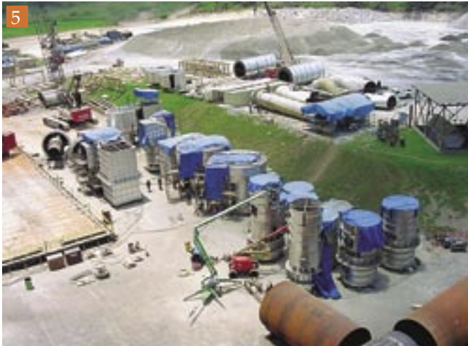
I cicloni a terra prima dell'installazione. Vessels on the ground before installation.
